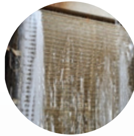
รูปแผ่นทำน้ำเย็นที่ผิดปกติ
